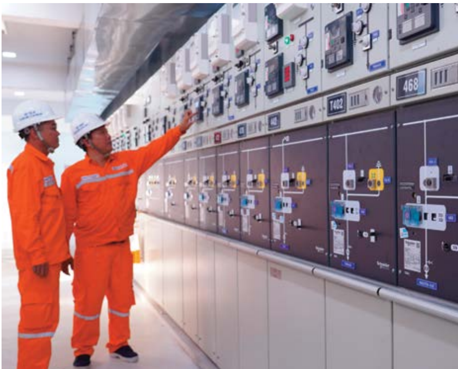
EVNHCMC đảm bảo cung ứng điện đầy đủ, ổn định trên địa bàn TP.Hồ Chí Minh.
